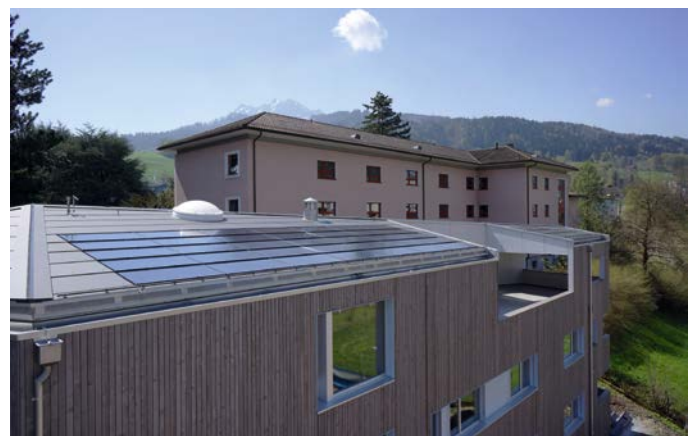
Photovoltaikanlage und Wetterstation auf dem Dach sind mit dem Gebäudesystem verbunden.
